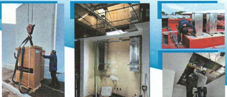
SUMINISTRO Y COLOCACION DE AIRE ACONDICIONADO PARA EL QUIROFANO DEL HOSPITAL GENERAL Y LAS UNIDADES DE ATENCION MEDICA CRUZ VERDE NORTE Y SUR
