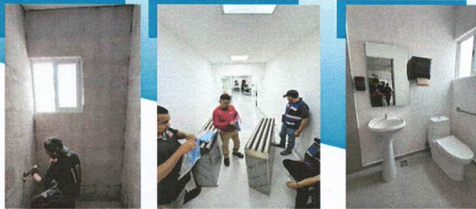
REHABILITACION DE AREAS DE PATOLOGÍA, TRABAJOS COMPLEMENTARIOS EN QUIROFANOS Y OBRAS ADICIONALES EN EL HOSPITAL GENERAL DE ZAPOPAN
